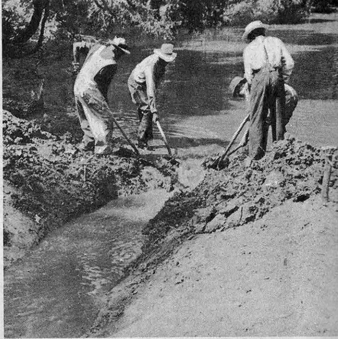
... alors qu'à droite des ouvriers creusent un fossé de drainage qui permettra l'écoulement des eaux d'un marais.
