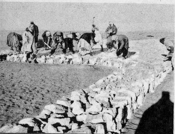
● Édification, dans l'oued Noumerate, d'une route empierrée en remblai à travers une zone de sable mou.
