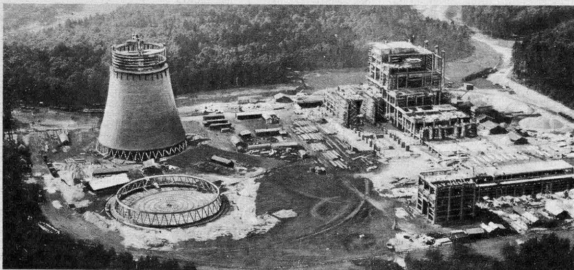
Pour tirer le meilleur parti de nos ressources en charbon, un programme de construction de centrales thermiques a été établi sitôt la guerre finie. La centrale minière de Carling (Lorraine) fournira une puissance de 440 000 kilowatts.
