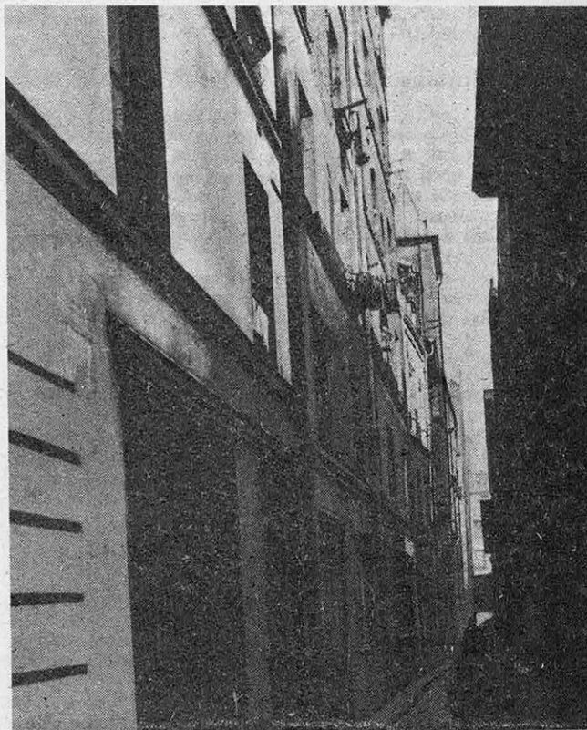
QUATRIÈME CATÉGORIE 12, impasse Briare, IX e . Bâtie en 1820, construction en désagrégation. Accès difficiles et sombres, aucun confort : poste d'eau, un "W.-C." par palier, pas de tout-à-l'égout.
