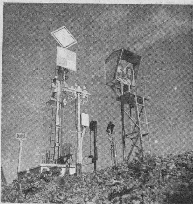
FIG. 2. — SIGNAL CARRÉ ET SIGNAL D'AVERTISSEMENT GROUPÉS SUR LE MÊME MAT
