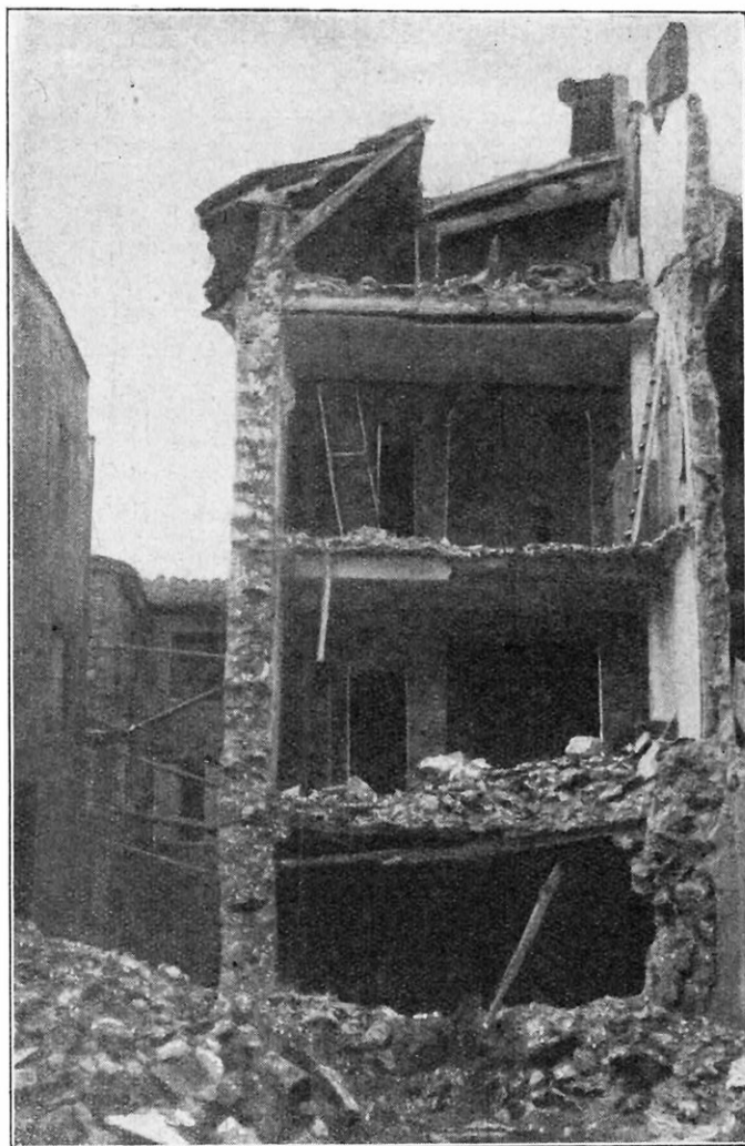
UNE MAISON COMPLÈTEMENT ÉVENTRÉE PAR UN TREMBLEMENT DE TERRE
