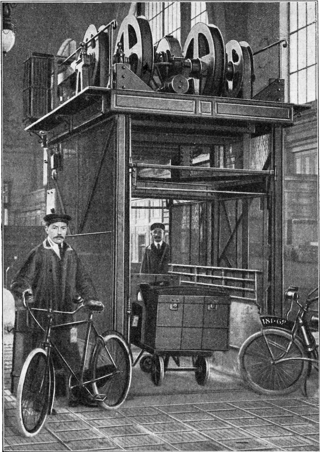
UN DES MONTE-CHARGES ÉLECTRIQUES DE LA GARE DU QUAI D'ORSAY
